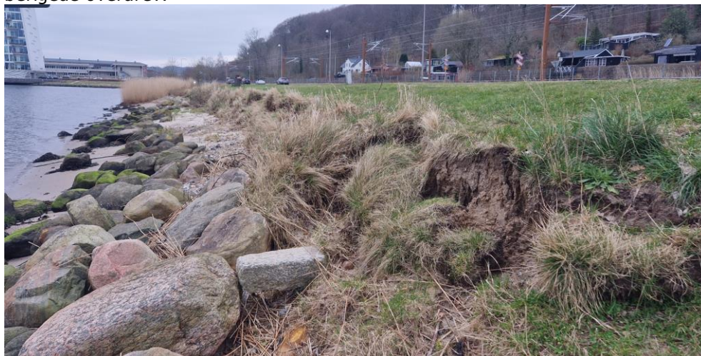
Figur 3-9 Foto taget mod vest, som viser kystsikring med spredte kampesten, fravær af tagrørssump samt en erosionspræget skrænt.
